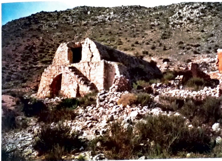
Foto 2. La cisterna de la Casa de Santos, a los pies de los «Alticos del Gordo». Puede apreciarse una gran grieta que amenaza con derrumbarla.
