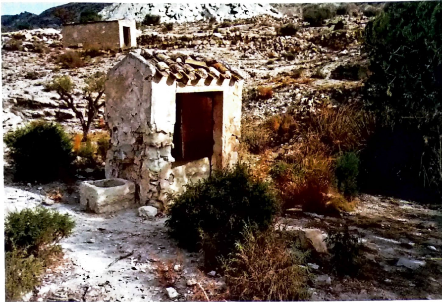
Foto 3. Aljibe de Bateig, con tejadillo a dos aguas, en la actualidad casi destruido.
